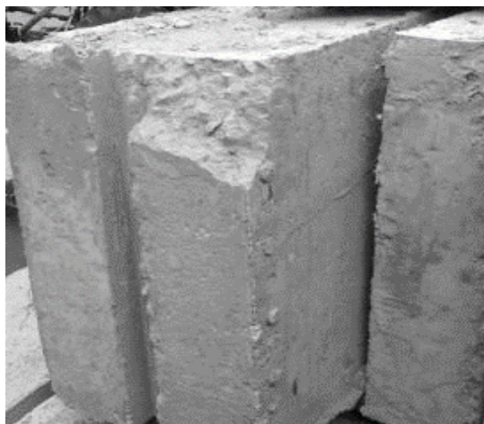
Рис. 7.3. Скол бетона без обнажения арматуры
