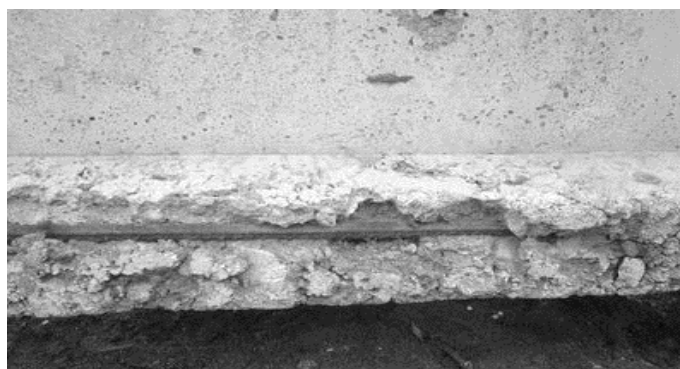
Рис. 7.4. Скол бетона до обнажения арматуры
